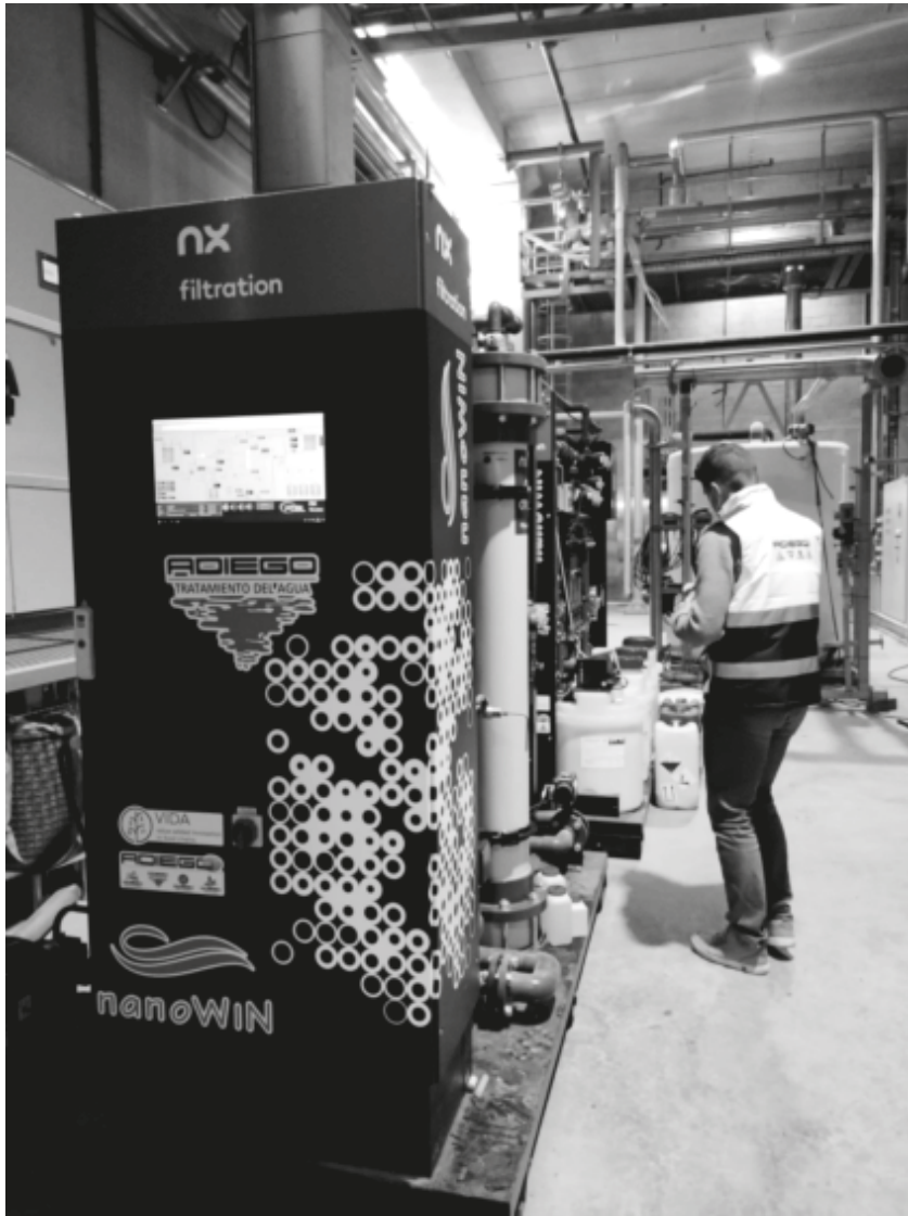
Figura 5. Planta de tratamiento de nanofiltración, NANOWIN.
